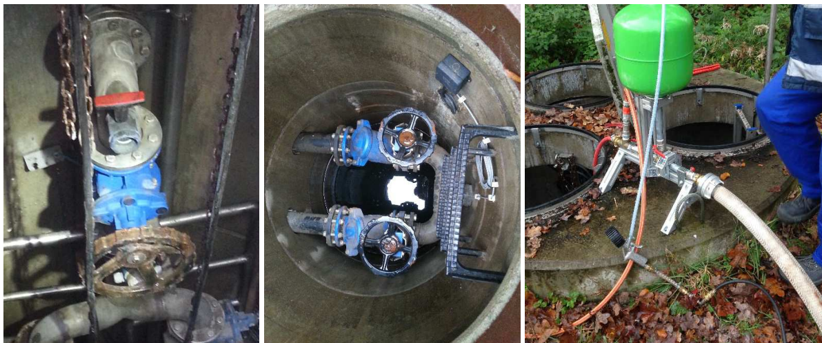
Bild 9 Spülstutzen im Pumpschacht (links), Drucksensor am Hochpunkt (mitte), Ausgleichsbehälter mit angeschlossenen C-Schlauch (rechts)
