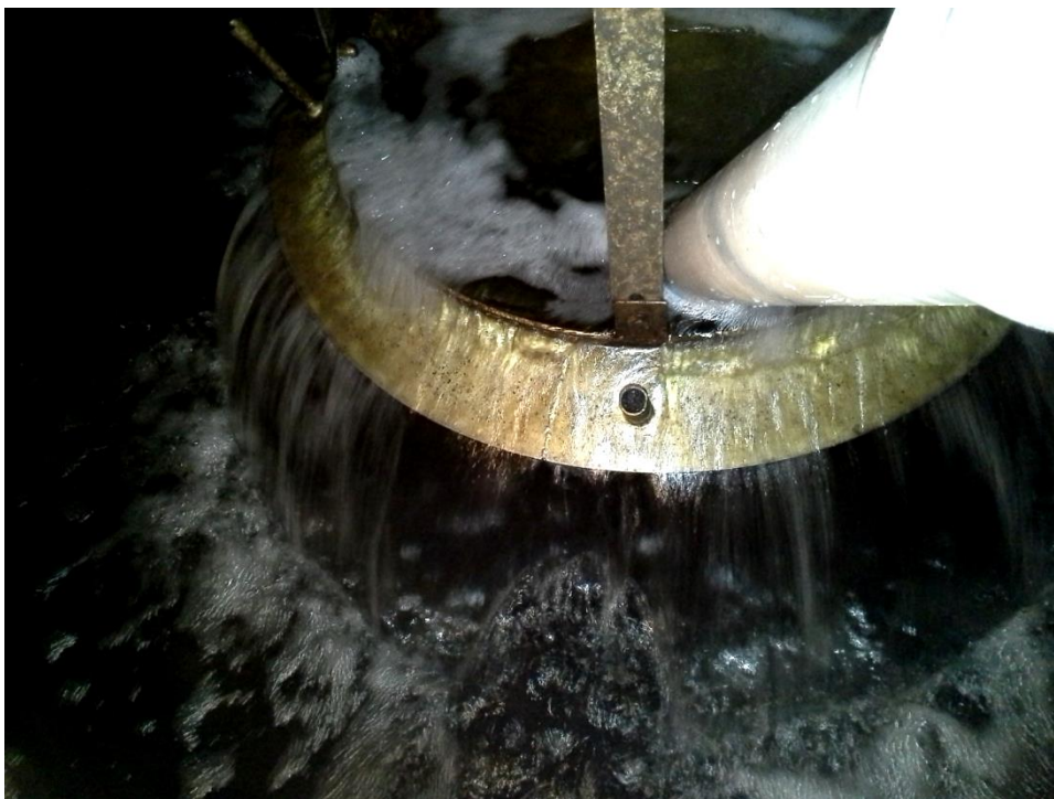
Abbildung 6: Beschickung des Adsorbers mit Filtrat der Flockungsfiltration direkt vom oberen Mannloch aus in die Filtertulpe hinein
