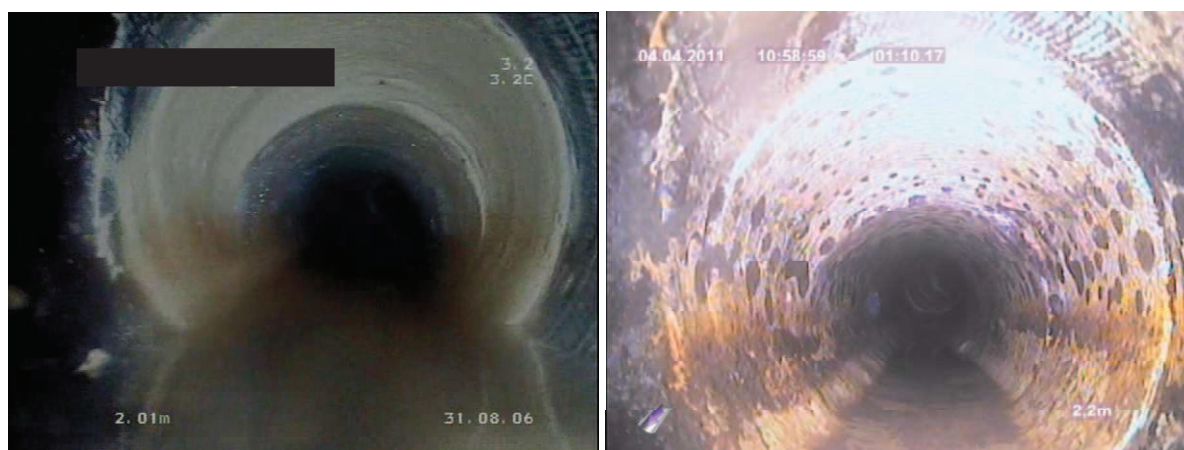
Abbildung 4-56: TV-Dokumentation eines per Inliner sanierten Hausanschlusses des Objektes 5AXI-V-V-XI (24) im Abstand von sieben Jahren (links: Aufnahme aus dem Jahr 2004, rechts: Aufnahme aus dem Jahr 2011)
