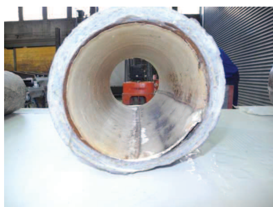
Abbildung 4-60: links: fehlender Verbund durch nicht gereinigte Sohle
