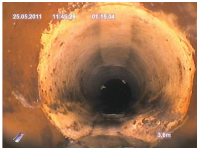
Abbildung 4-44: Kurzliner mit Beule in der Sohle (hier bei Objekt 6AXII-VI-VI-VI (10))
