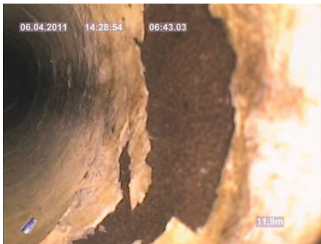
Abbildung 4-45: Materialablösungen in einem Inliner (hier bei Objekt 11BXIII-VIII-V-XI (17))
