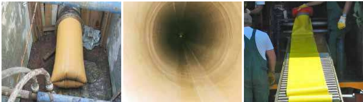
Bild 103 Der Liner kommt am Rohrende an (links), fertiggestellter Liner nach der TV-Befahrung (mitte), Der Liner wird zur Zwei-Komponenten Harzbefüllung auf dem Förderband vorbereitet (rechts) [103]
