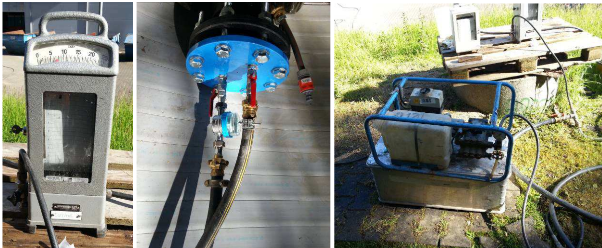
Bild 59 Druckmessgerät mit Druckanzeige und Schreiber (links), Blindflansch mit montierter Apparatur (mitte), Kolbenpumpe zum Aufbringen des Systemprüfdruckes (rechts)
