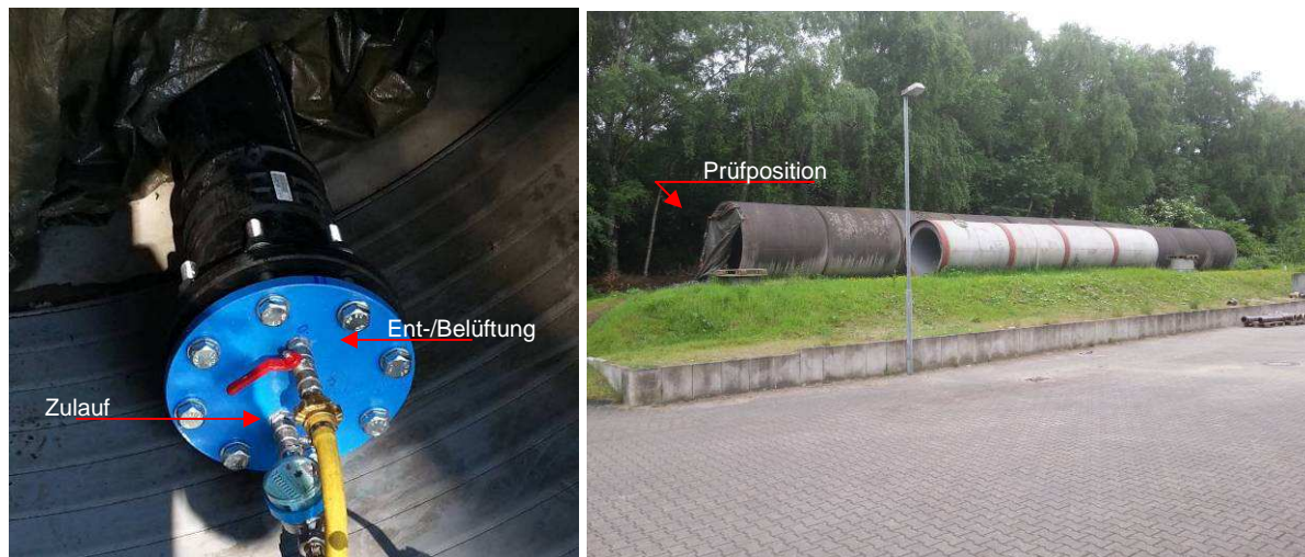
Bild 35 Prüfposition der Dienstleister (rechts), freigelegtes Ende der Versuchsstrecke mit einem Ent-/Belüfter und einem Zulauf in ½“ (links)
