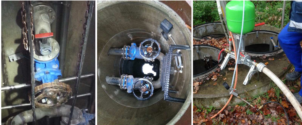
Bild 81 Spülstutzen im Pumpschacht (links), Drucksensor am Hochpunkt (mitte), Ausgleichsbehälter mit geschlossenem C-Schlauch (rechts)
