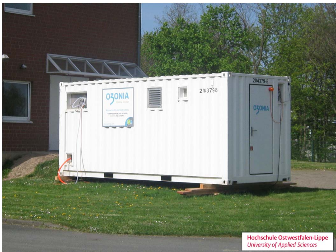
Abbildung 3-1: Halbtechnische Ozon-Versuchsanlage (Containerbauweise) der Fa. Ozonia – Degrémont Technologies Ltd., Dübendorf (CH) am Standort der ZKA Detmold
