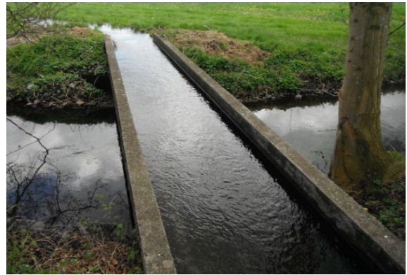
strukturell nicht schädlich
