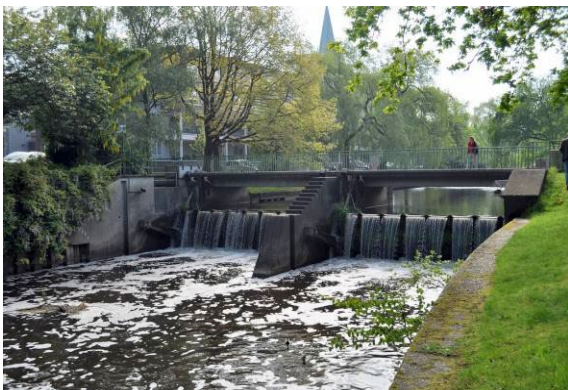
bewegliches Wehr 0,3 – 1 m
