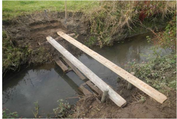
KEIN Kreuzungsbauwerk (wildes Bauwerk)
