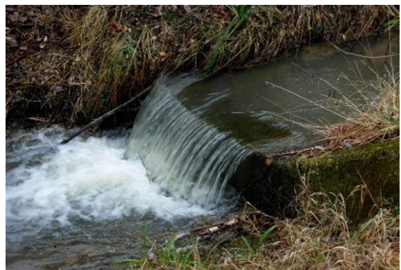
mittlerer Absturz 0,3 – 1 m
