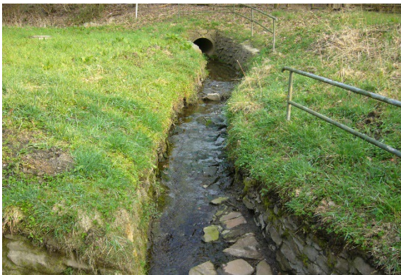
strukturell nicht schädlich
