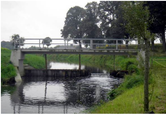
bewegliches Wehr 0,3 – 1 m
