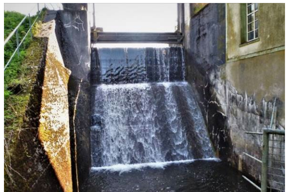
bewegliches Wehr > 1 m
