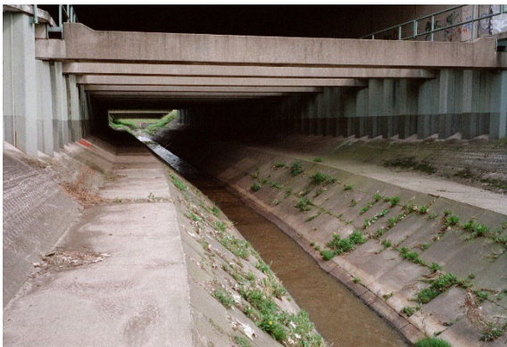
strukturell nicht schädlich
