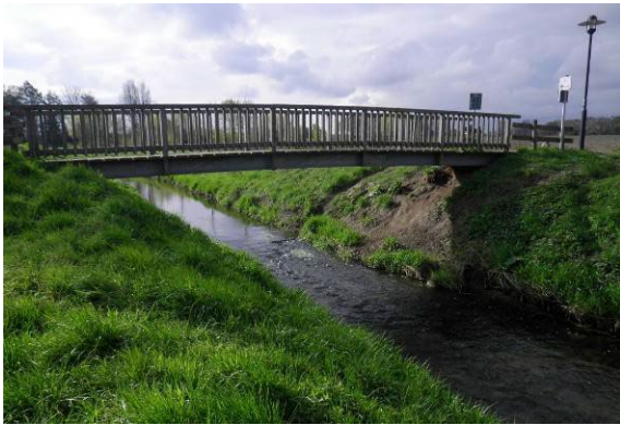
strukturell nicht schädlich
