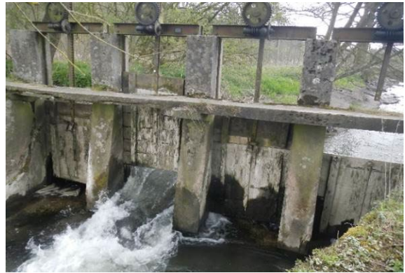
bewegliches Wehr 0,3 – 1 m
