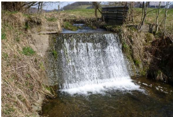
hoher Absturz > 1 m
