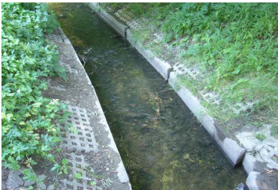
Massivsohle mit Sediment
