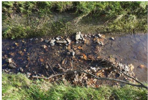
Massivsohle mit Sediment
