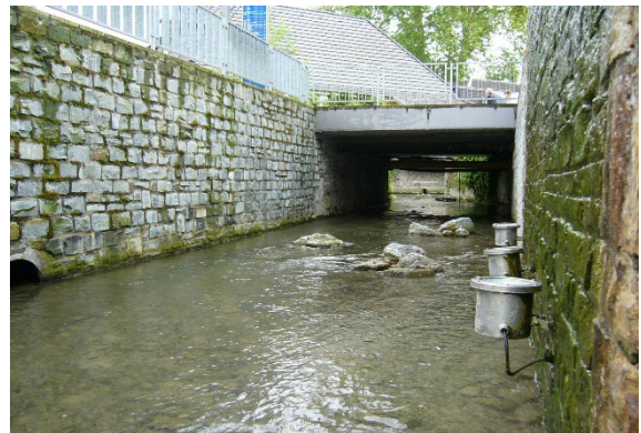
strukturell nicht schädlich
