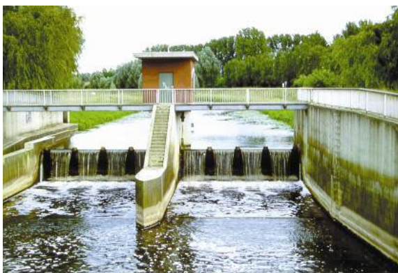
bewegliches Wehr > 1 m mit Fischwanderhilfe (links)
