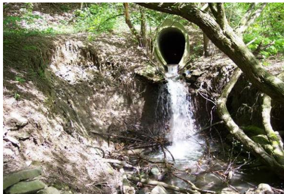
hoher Absturz > 1 m
