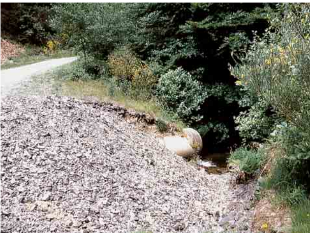
5 – 20 m, Absturz hoch
