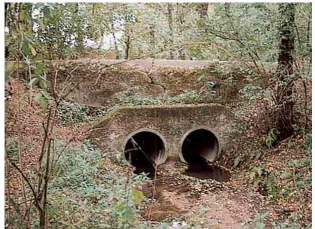
Lauf verengt, ohne Sediment (außerdem: Verrohrung 5 – 20 m)
