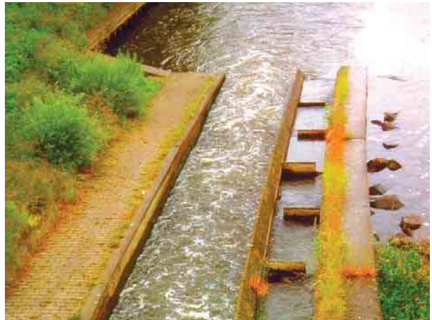
Bootsgasse (links) und technischer Fischpass
