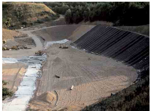
Anschüttung, Müllablagerung: Deponie
