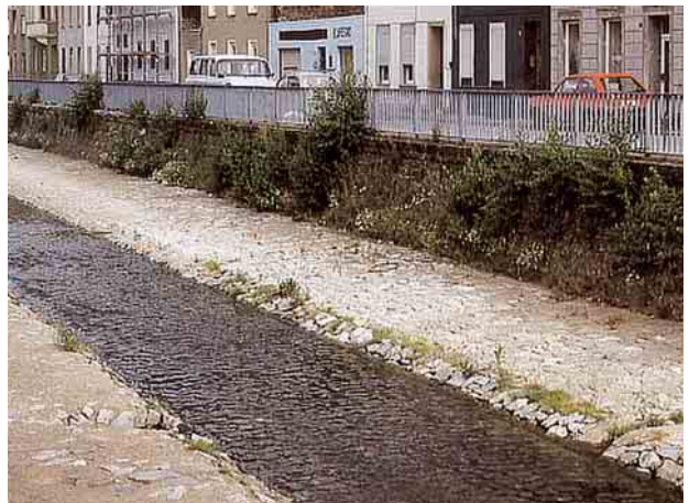
Massivsohle mit Sediment
