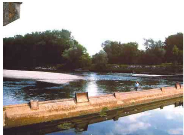
Absturz ab 20 cm (Aufstau nicht in Betrieb)
