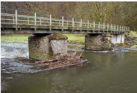
Brücke, Lauf verengt, mit Sediment
