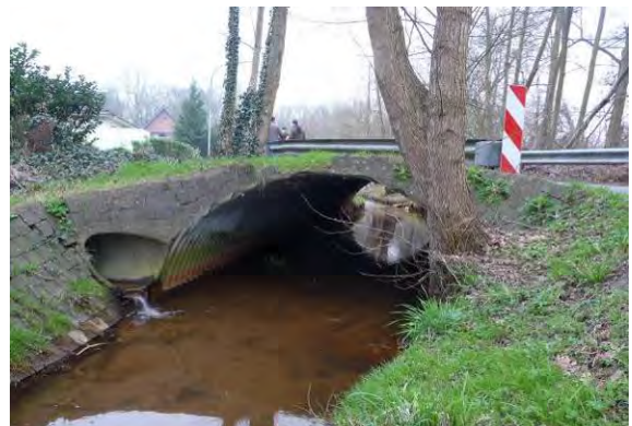
Durchlass, unverbautes Ufer unterbrochen, mit Sediment
