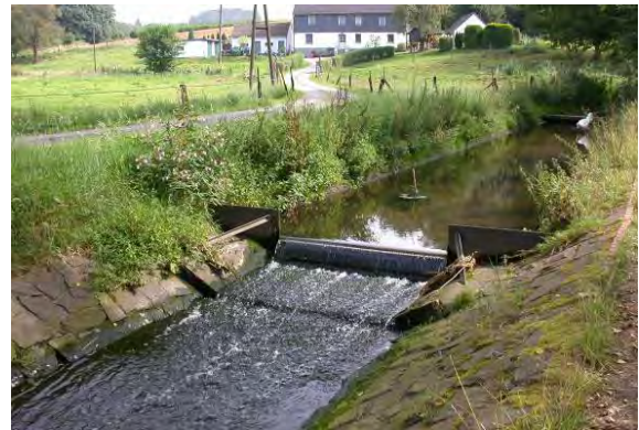
Absturz, unterhalb glatte Gleite
