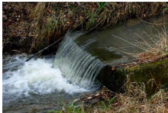
mittlerer Absturz 0,3 – 1 m
