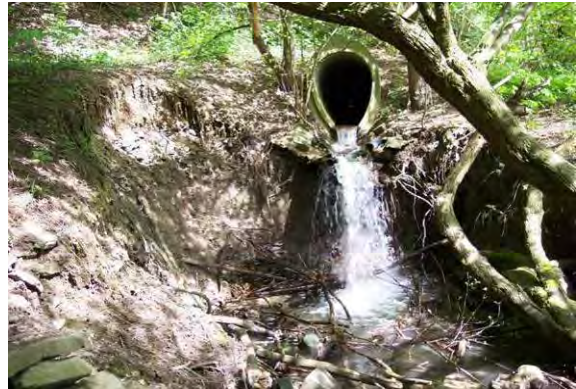
hoher Absturz > 1 m
