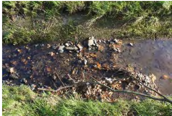
Massivsohle mit Sediment
