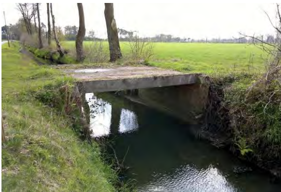
Brücke, unverbautes Ufer unterbrochen, mit Sediment
