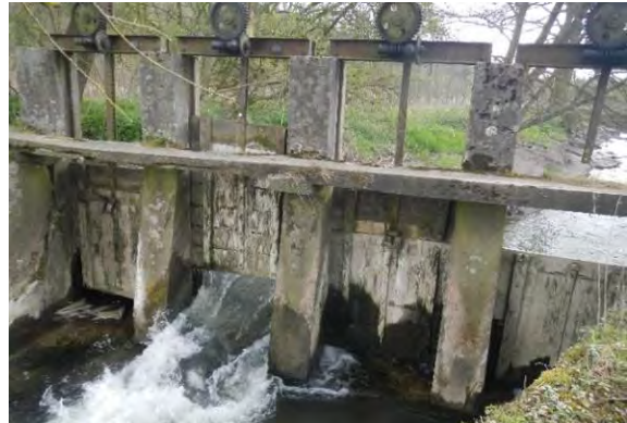
bewegliches Wehr 0,3 – 1 m
