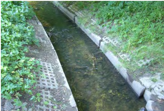
Massivsohle mit Sediment
