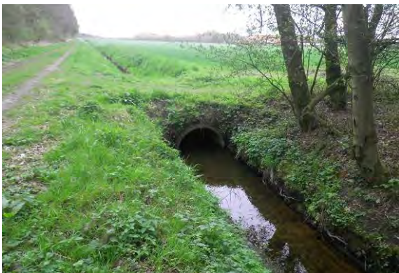
Durchlass, unverbautes Ufer unterbrochen, mit Sediment
