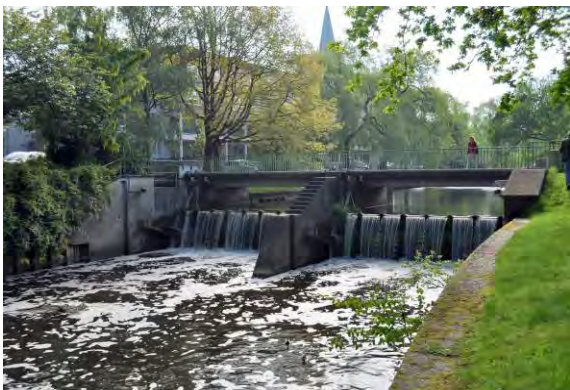
bewegliches Wehr 0,3 – 1 m
