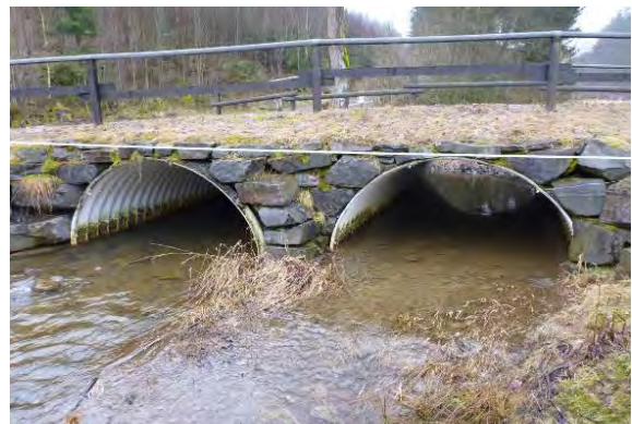
Durchlass, Lauf verengt, mit Sediment
