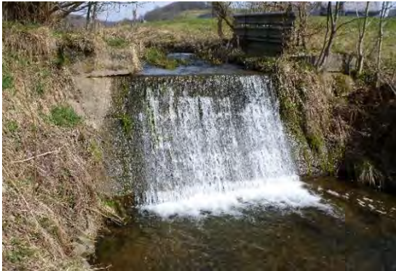
hoher Absturz > 1 m
