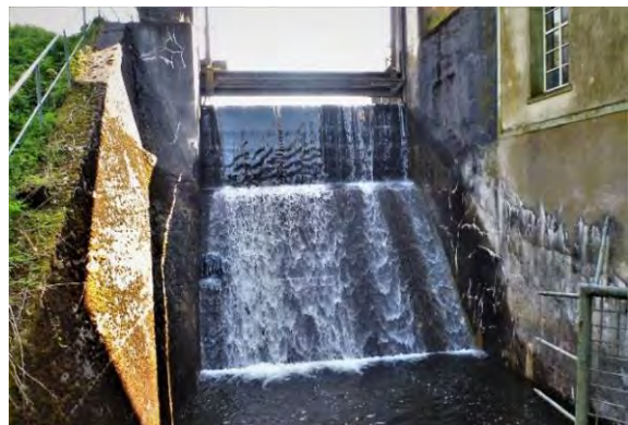
bewegliches Wehr > 1 m
