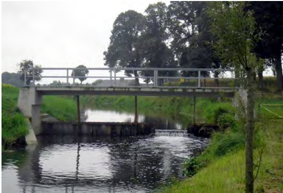
bewegliches Wehr 0,3 – 1 m
