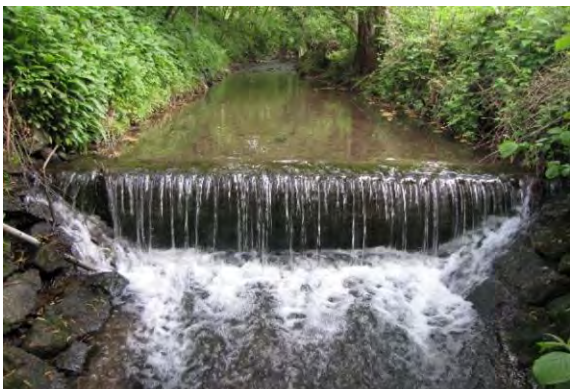
mittlerer Absturz 0,3 – 1 m
