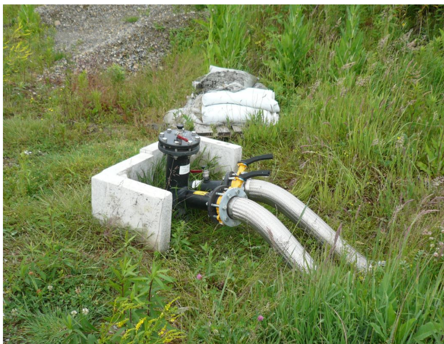
Abbildung 17 Gasbrunnen für eine Aerobisierungsmaßnahme
