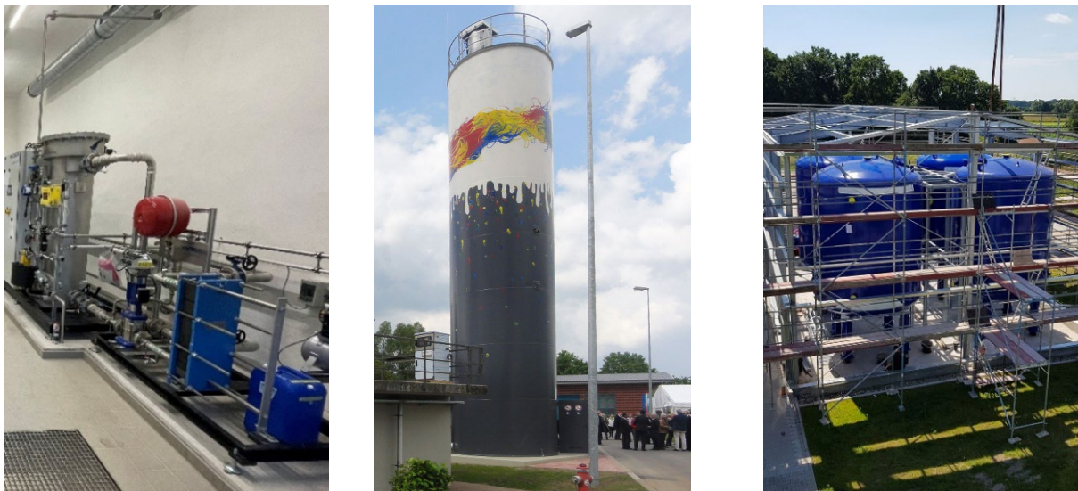
Abbildung 4: Beispiele für ausgeführte Verfahrensstufen zur Mikroschadstoffreduktion in Nordrhein-Westfalen, links: Ozongenerator Kläranlage Lemgo, Abwasserbeseitigungsgesellschaft Lemgo GmbH (Foto: Abwasserbeseitigungsgesellschaft Lemgo GmbH), Mitte: PAK-Silo Kläranlage Dülmen, Lippeverband (Foto: Hydro-Ingenieure GmbH), rechts: GAK-Kessel Kläranlage Harsewinkel, Stadt Harsewinkel (Foto: Hydro-Ingenieure GmbH)
