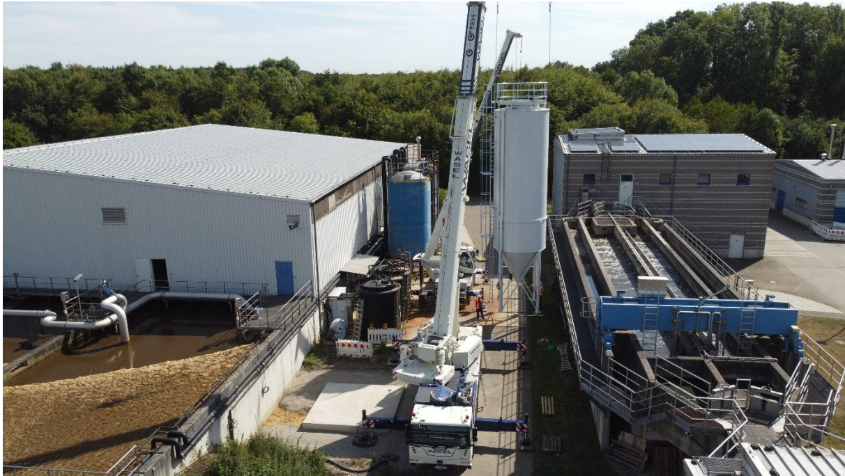
Bild 5.2: Aufbau des Pulveraktivkohlesilos auf der Kläranlage Kaarst-Nordkanal des Erftverbands (Foto: Erftverband)
