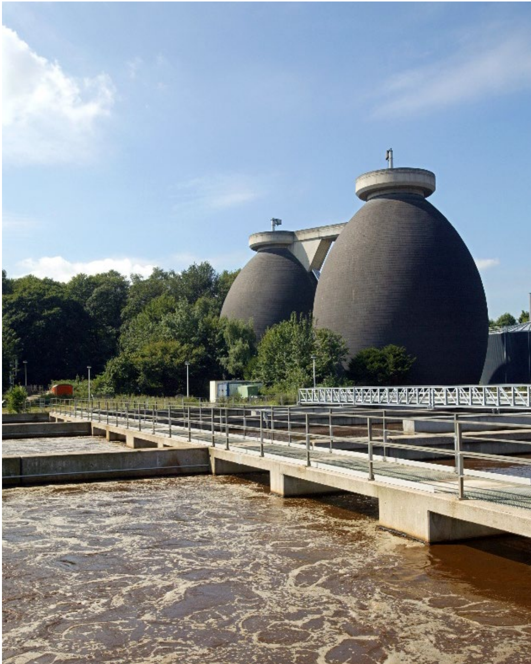
Bild 9.1: Faultürme auf der Kläranlage Hagen (Ruhrverband)
