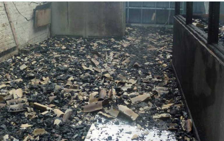
Bei einem Brand zerspringt Wellasbest in kleine Stücke
