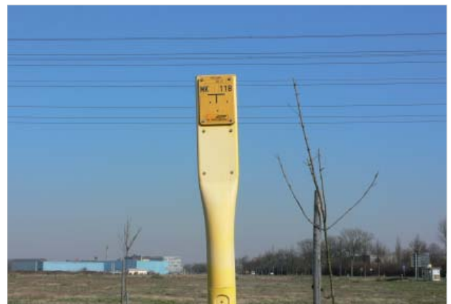
Gasfernleitung in der Nähe einer Industrieanlage
