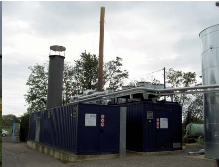
Blockheizkraftwerk zur Biogasverwertung
