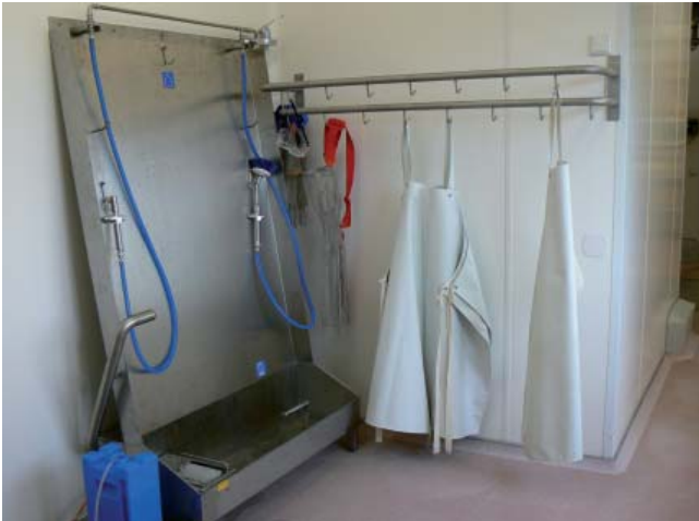
Hygieneschleuse in einem handwerklichen Betrieb
