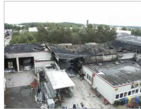
Ausgebrannte Lager- und Produktionshalle
