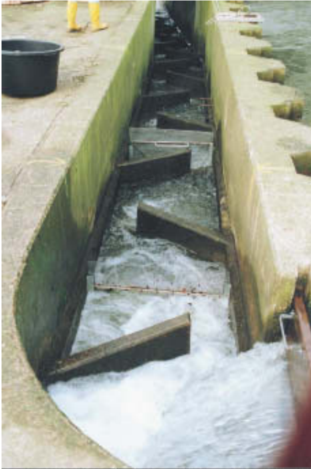
Abb. 10: Herkömmliche Fischtreppe, Essen-Horst
