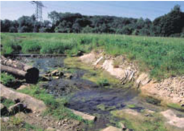
Abb. 6: Hochwasserschäden (Winter 1998/99) an den Sohlgleiten des neugebauten Abschnitt des Deininghauser Baches – Indiz für fehlende Mischwasserrückhaltekapazität.
