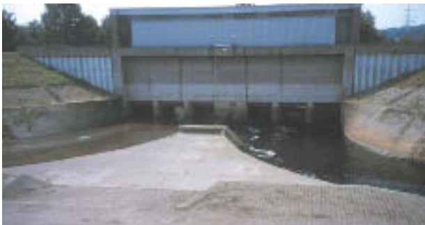
Abb. 12: Ein Fluss wird geklärt. Ein- und Auslauf der Mündungskläranlage in Dinslaken. Bis zu einem Abfluss von 30 m³/s wird die gesamte Emscher gereinigt.
