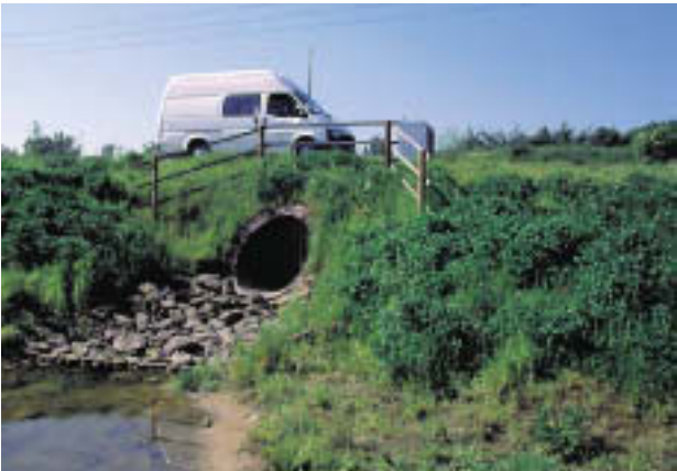
Abb. 5: Auslass eines Mischwasserabschlages in die renaturierte Bachaue (Nierholzstr.).
