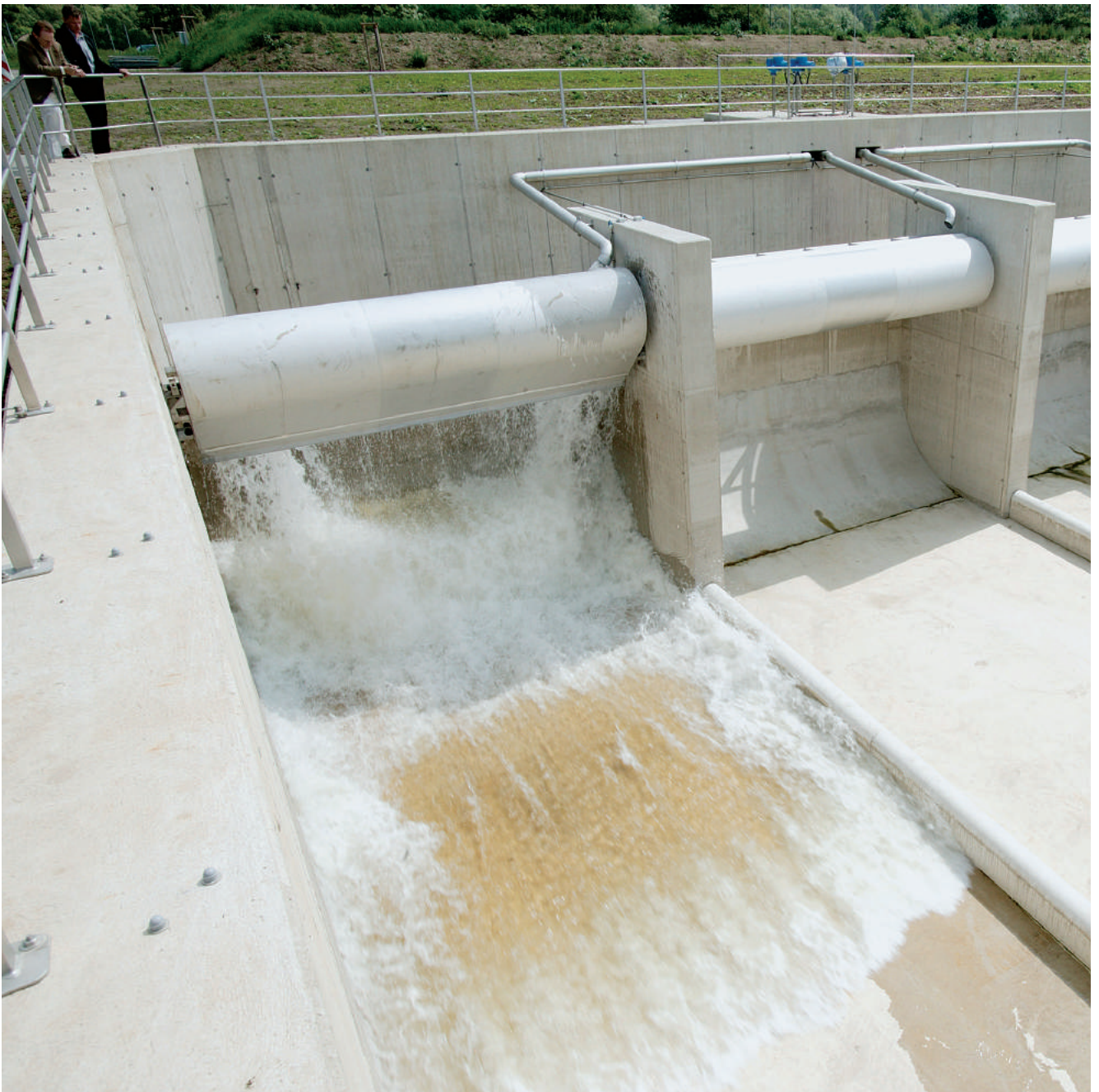
Funktionsprüfung an einem Regenüberlaufbecken
