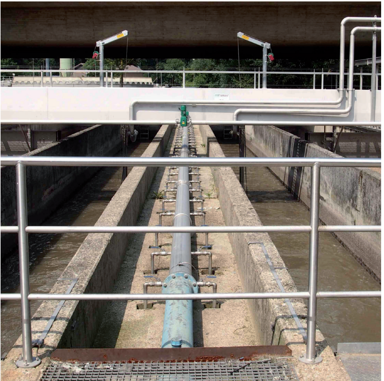
Sand- und Fettfang der Kläranlage Aachen-Soers
