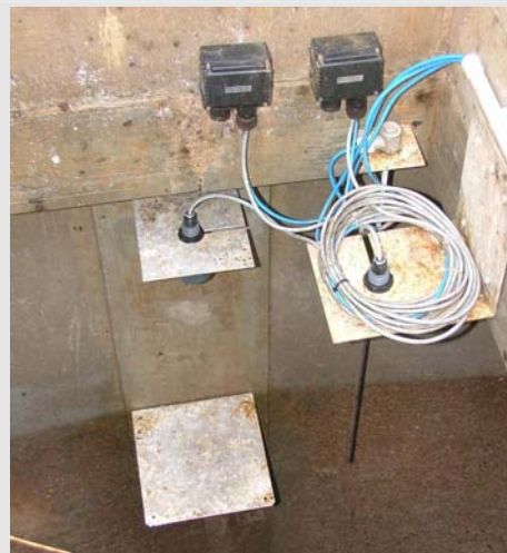
Ultraschall- und Stabsonde zur Bestimmung der Entlastungshöhen am Beckenüberlauf
