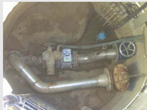
Drosseleinrichtung (MID & Regelschieber) zur Begrenzung der Abflüsse aus dem RÜB
