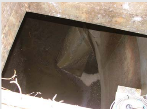
Ultraschallsonde im Zulaufbereich des RÜB zur Bestimmung der Beckenfüllstände
