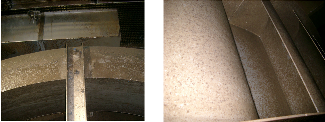
Bild 6.2: Zulaufgerinne zum Wasserrad mit Wasserradkasten sowie Einblick in eine Wasserradtasche (24 Monate nach Inbetriebnahme ohne Reinigung)
