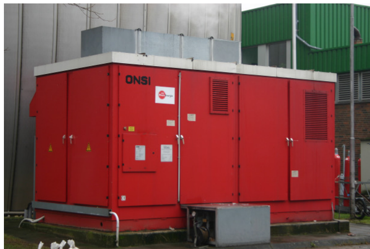
PC25C im Klärwerk Köln-Rodenkirchen
