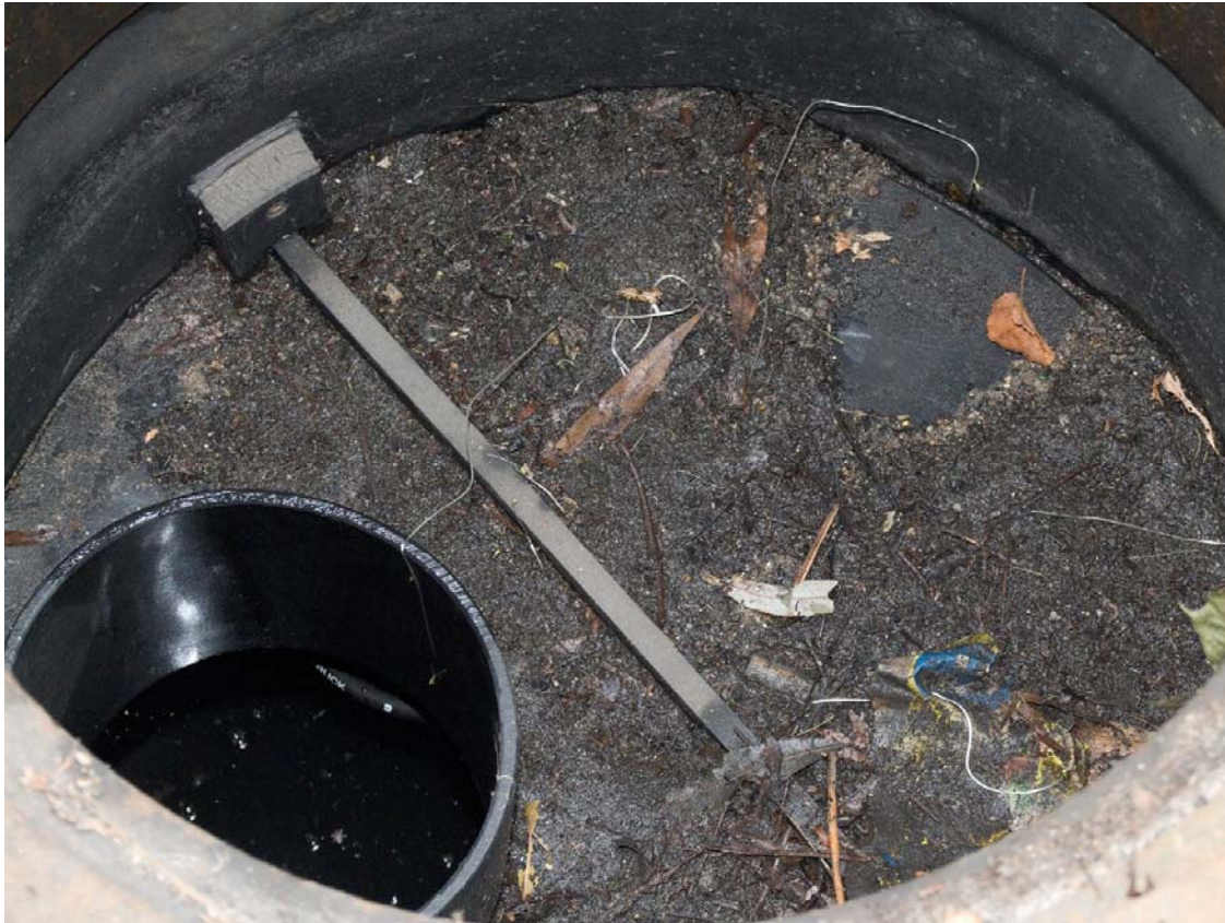
Abbildung 41: Blick in den Nassschlammfang; Strömungskanal oben rechts führte zu einem Feststoffaustrag in die unteren Kammern
