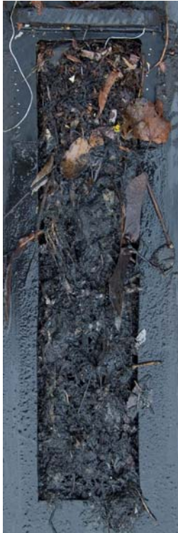
Abbildung 42: Verblockter Koaleszenzfilter während der Reinigung des Centrifloel-Systems nach der Betriebsphase I
