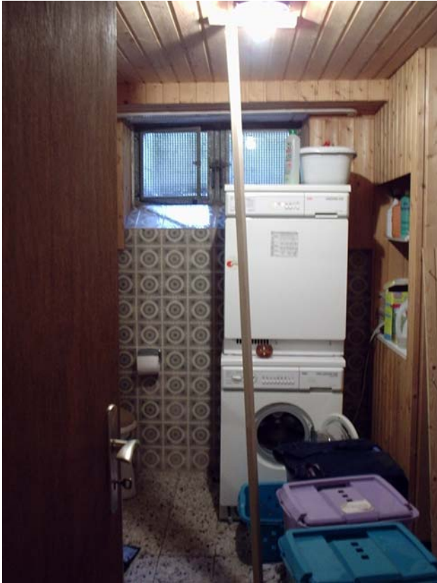
Abbildung 21: Rückstausicherung Marke Eigenbau I
