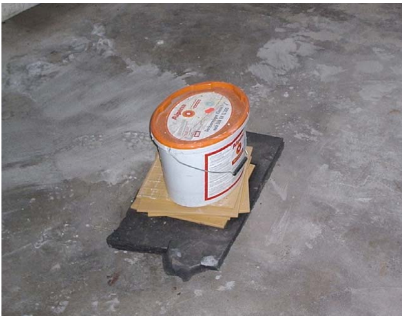
Abbildung 22: Rückstausicherung Marke Eigenbau II
