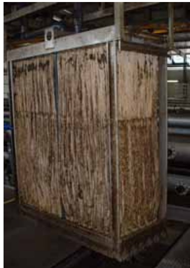
Abbildung 8-25: großtechnisches ZENON®-Membranmodul des GWK Nordkanals
