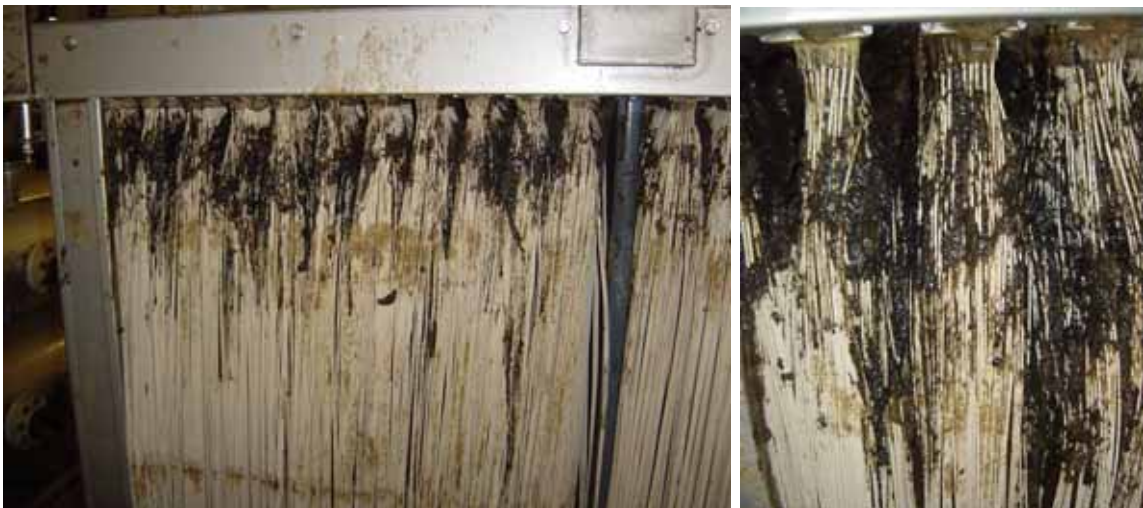
Abbildung 4-1: Membranmodul (links) und Verzopfungen (rechts) aus dem Betrieb der KA Nordkanal, im Oktober 2004.
