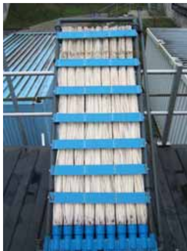
Abbildung 8-22: PURON®-Modul der Pilotanlage Nordkanal
