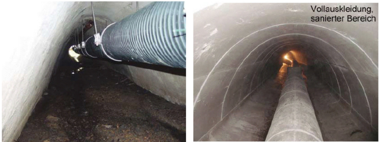
Bild 74 Rohr-in-Rohr-Lösung zur Ableitung von Fremdwasser (links abgehängte Fremdwasserleitung in Göppingen, rechts Sohlleitung zur Ableitung eines Baches im Mischwassersammler in Freiberg/Sachsen (Bildmaterial: Kovacic Ingenieure GmbH, Sigmaringen) [149]
