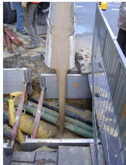
b) Detailansicht mit mehreren parallel verlegten Versorgungsleitungen
