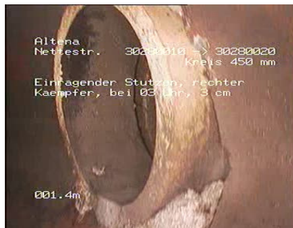
Bild 107 Beispiel für die Schadensart: Einragender Stutzen (Kürzel: SE) – Schadensort: „Nettestraße“ (Bildmaterial: S & P Consult GmbH)
