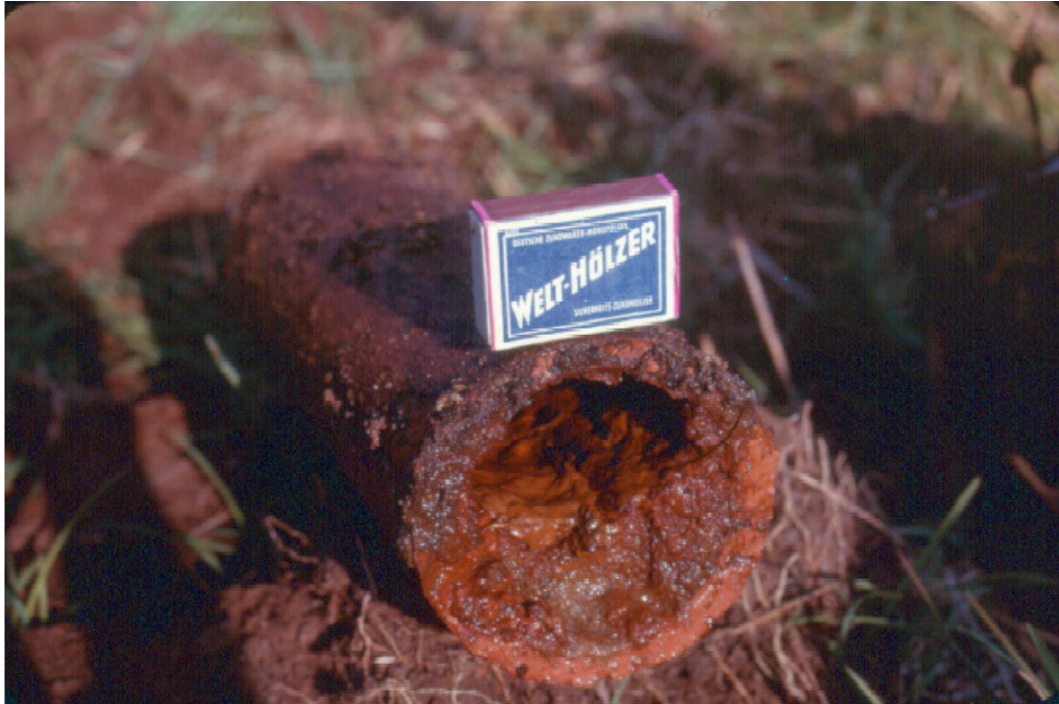
Bild 56 Beispiel der Verockerung einer Dränleitung [119]
