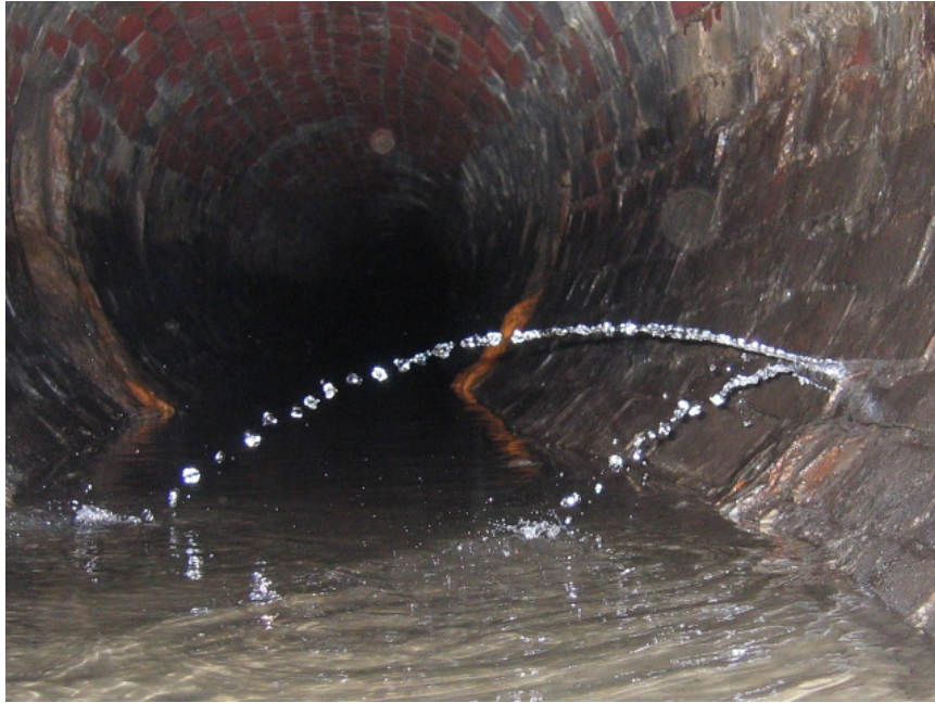
Bild 2 Grundwasserinfiltration in einen Abwasserkanal über eine undichte Mauerwerksfuge (Bildmaterial: S & P Consult GmbH)
