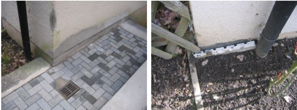
Bild 92 Sanierte Bauwerksschäden infolge des Schichten- und Grundwassers (Bildmaterial: S & P Consult GmbH)
