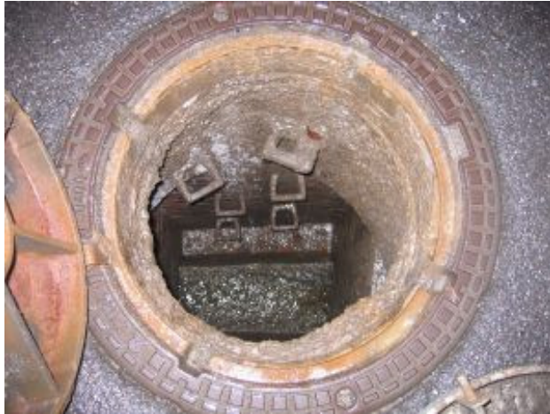
Gemessener Fremdwasseranfall an Messstelle 5 (M 5) mit Q = 46,75 \text{ l/s}
