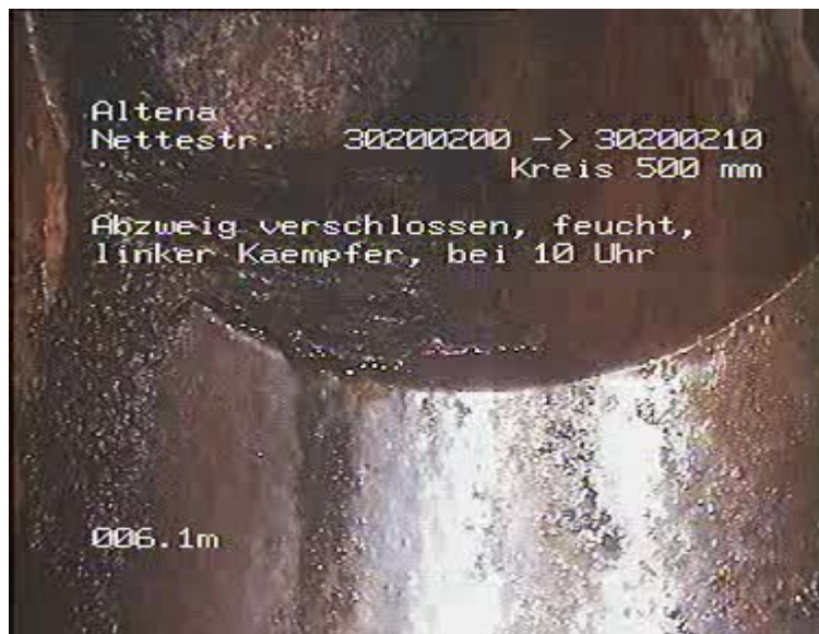
Bild 108 Beispiel für die Schadensart: Verschlossener Abzweig (Kürzel: SU) – Schadensort: „Nettestraße“ (Bildmaterial: S & P Consult GmbH)
