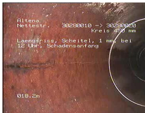
Bild 101 Beispiel für einen Längsriss (Kürzel: RL-1 mm) - Schadensort: „Nettestraße“ (Bildmaterial: S & P Consult GmbH)
