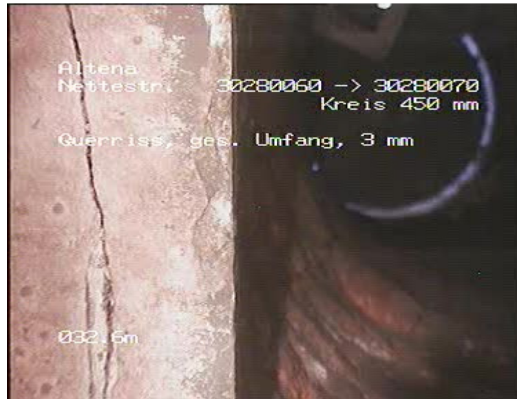
Bild 104 Beispiel für einen Querriss am Gesamtumfang (Kürzel: RQ-3 mm) - Schadensort: „Nettestaße“ (Bildmaterial: S & P Consult GmbH)
