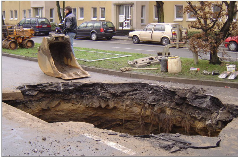
Bild 80: Großflächiger Straßeneinsturz (Tagbruch) aufgrund einer nicht fachgerecht ausgeführten, undichten Einbindung eines Seitenzulaufs in einen Hauptsammler (Bildmaterial: S & P Consult GmbH)
