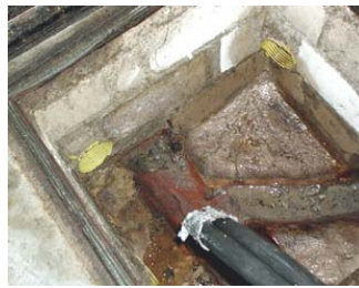
B) feuchte Dränagen am Schacht
