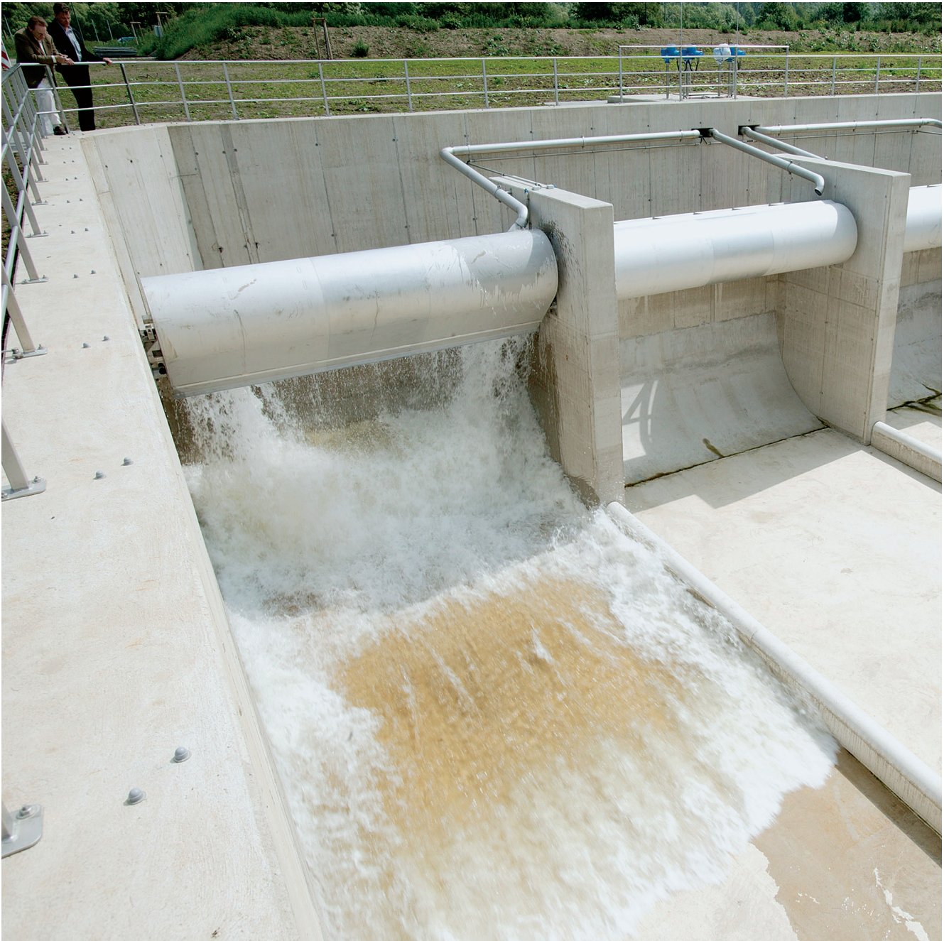
Funktionsprüfung an einem Regenüberlaufbecken
