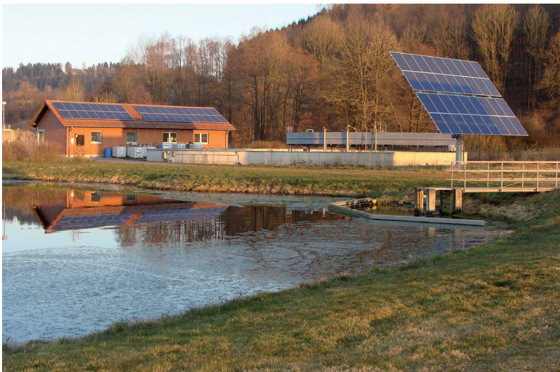
Photovoltaik auf der Kläranlage Bad Wünnenberg
