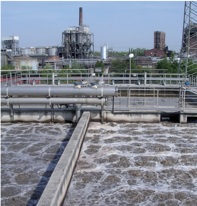
Vorbehandlungsanlage (Festbettbiologie) eines Industriebetriebes in in Castrop-Rauxel
