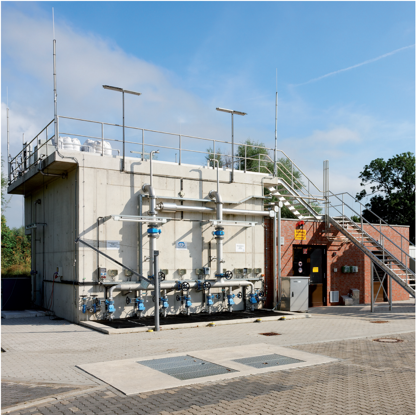
Kläranlage Duisburg-Vierlinden – Ozonung
