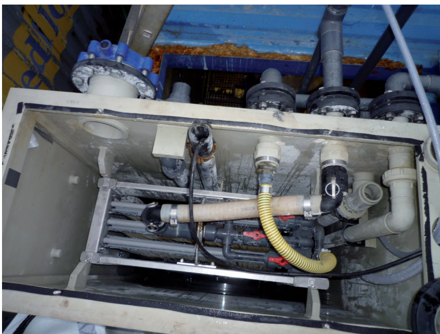
Membranmodul – Kläranlage Neuss-Ost
