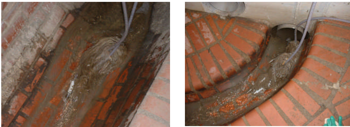
Abbildung 4-4: Verzopfungen an den Saugankern der Firma Dr. Lange im Zulauf (Bild links) und im Ablauf (Bild rechts)
