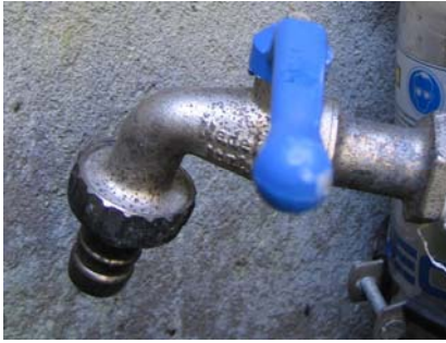
Bild 1: Probenahmehahn der Kleinkläranlage mit UV-Entkeimung
