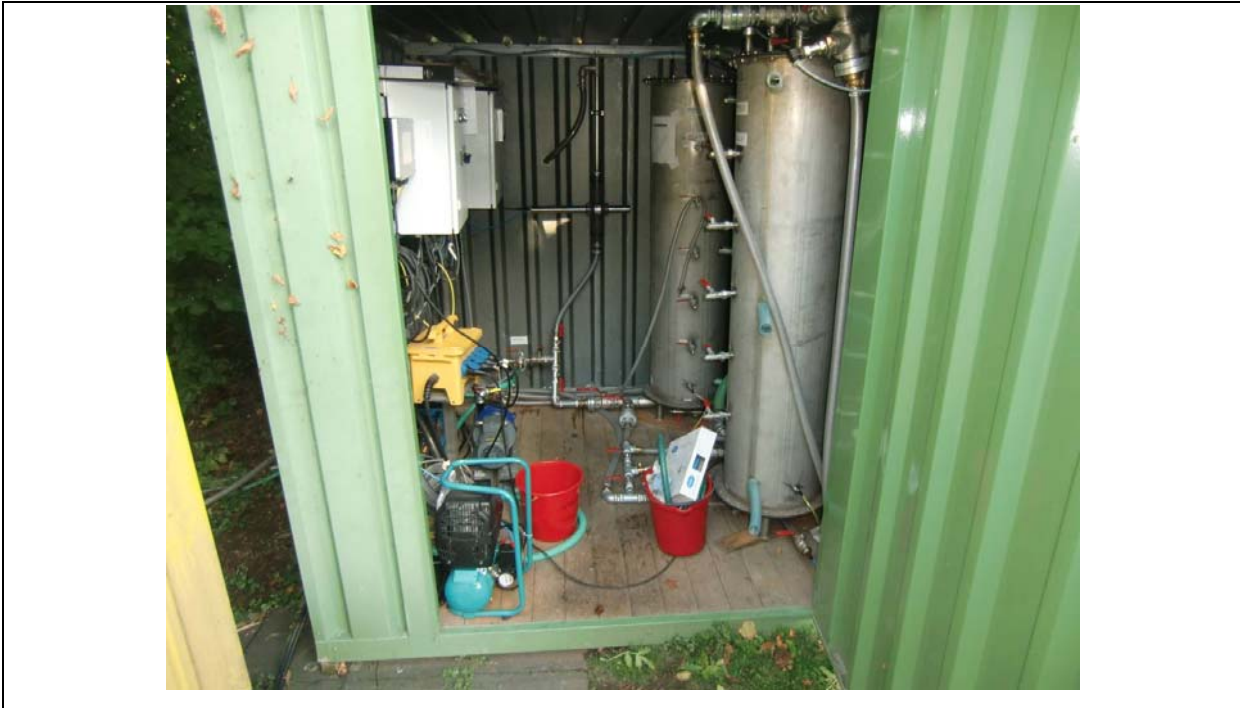
Bild 11: Halbtechnische Filtersäulen (rechts) im Container
