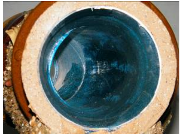
Steinzeug-Bogen 30°, DN 150, horizontal angeordnet, Scherbenbildung in der Sohle, gegen Fließrichtung
