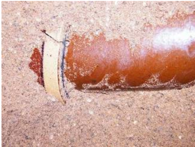
Abbildung 68: Rohrverbindungsbereich mit Undichtigkeit während des Ausbaus
