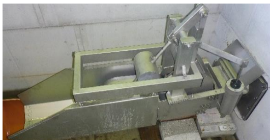
a) Waage-Drossel im Trockenwetterzustand
