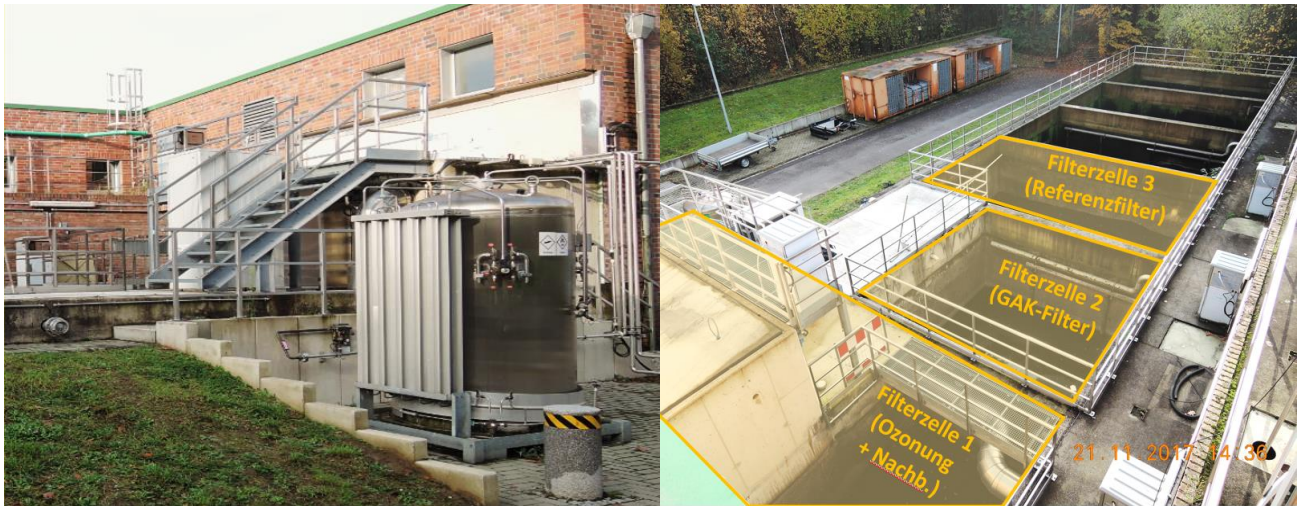
Bild 3: Umgebaute Filteranlage im Klärwerk Köln-Rodenkirchen (links: Seitenansicht, rechts: schräge Draufsicht)
