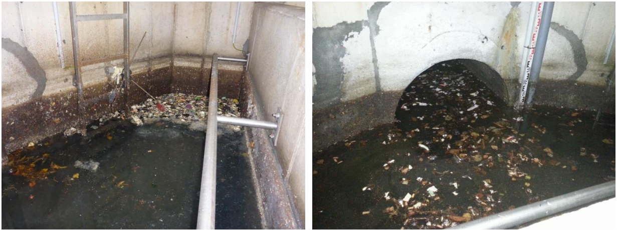
Bild 21: Zulaufsituation am 08.09.2014 (linkes Foto) und am 23.09.2014 (rechtes Foto)
