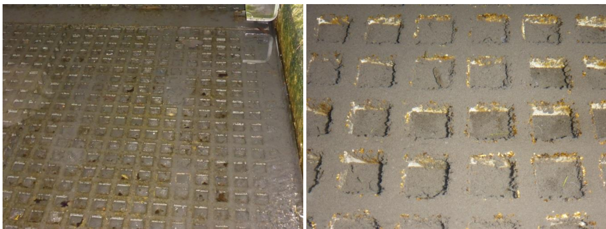
Bild 54: Sediment oberhalb des Filters nach Regenereignis (Foto vom 08.09.2014)
