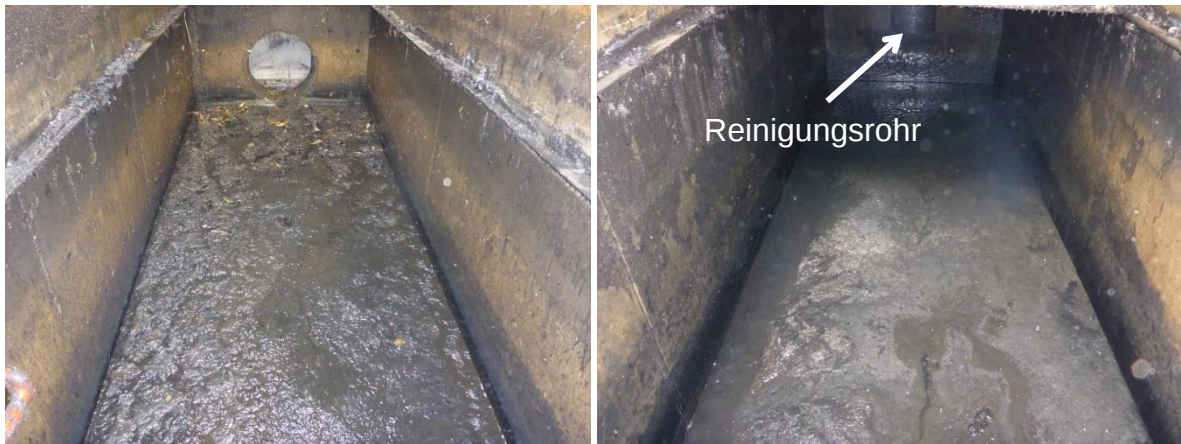
Bild 53: Schlammablagerungen Filterstraße (Foto vom am 07.07.2015)
