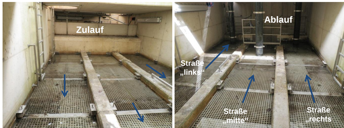
Bild 5: Großfilteranlage „In der Fleute“ in Wuppertal Blick Zulauf (links) und Blick Ablauf (rechts)
