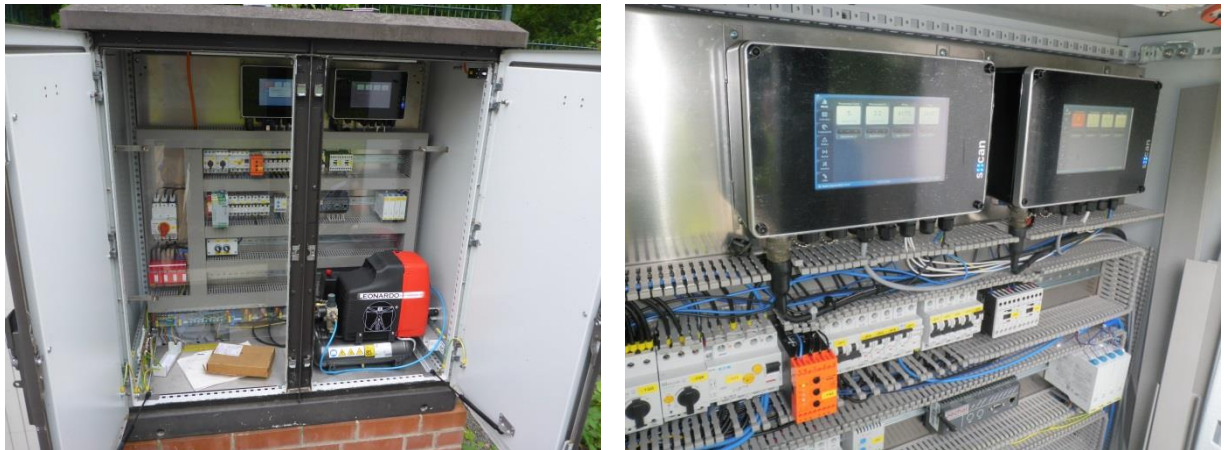
Bild 11: Bedienrechner (Fa. s::can) und Datenfernübertragungseinheit im Schaltschrank auf dem Betriebsgelände des Filters
