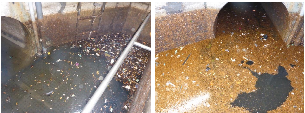
Bild 20: Zulaufsituation am 14.08.2014 (linkes Foto) und am 18.08.2014 (rechtes Foto)
