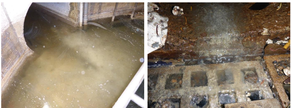
Bild 18: Hygieneartikel (linkes Foto vom 25.06.2014) und Biofilmbildung im Einlaufbereich (rechtes Foto vom 03.07.2014)
