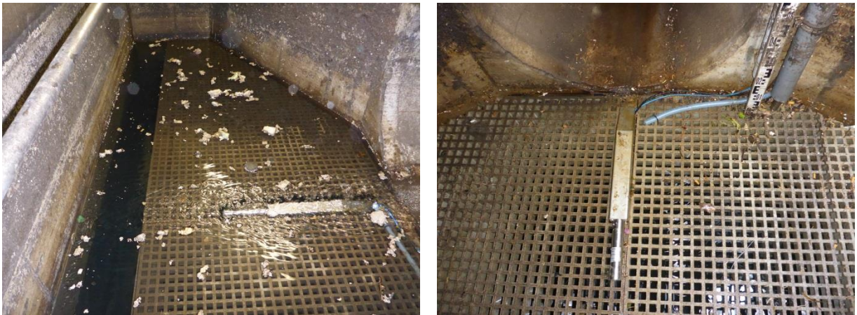
Bild 9: Installationsort Photometersonde Zulauf Großfilteranlage
