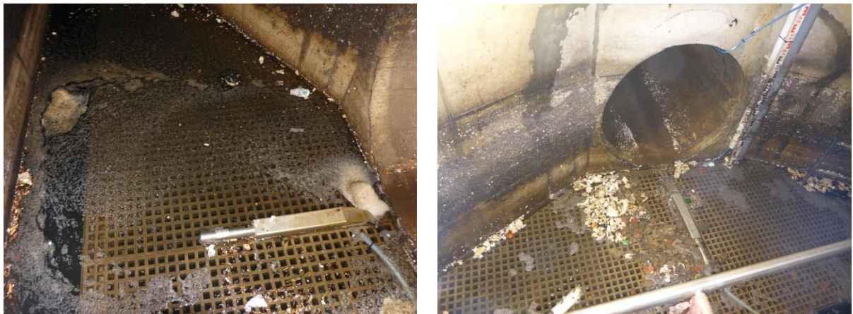
Bild 28: Zulaufsituation am 28.07.2015 (linkes Foto) und am 09.11.2015 (rechtes Foto)
